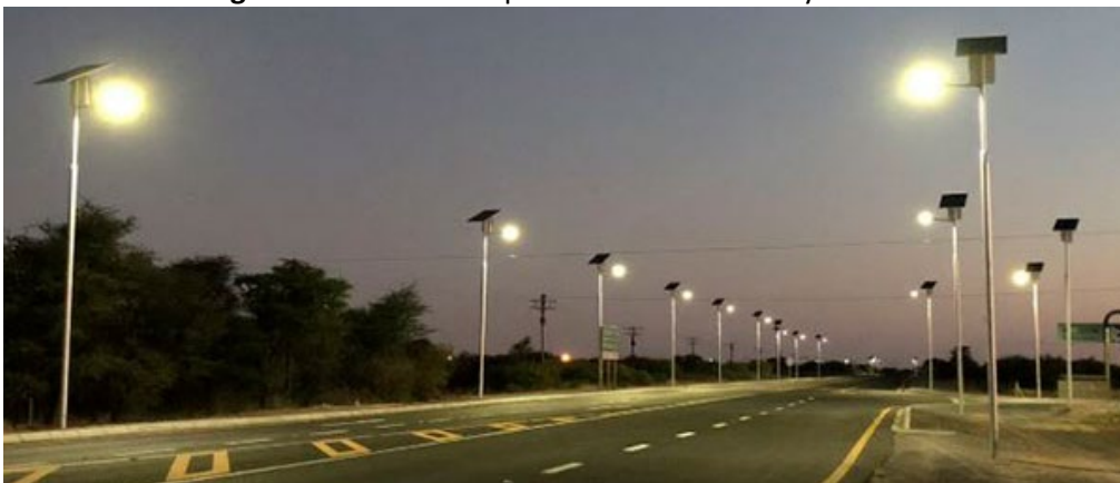
Figura 23: Alumbrado público solar en calles y caminos
